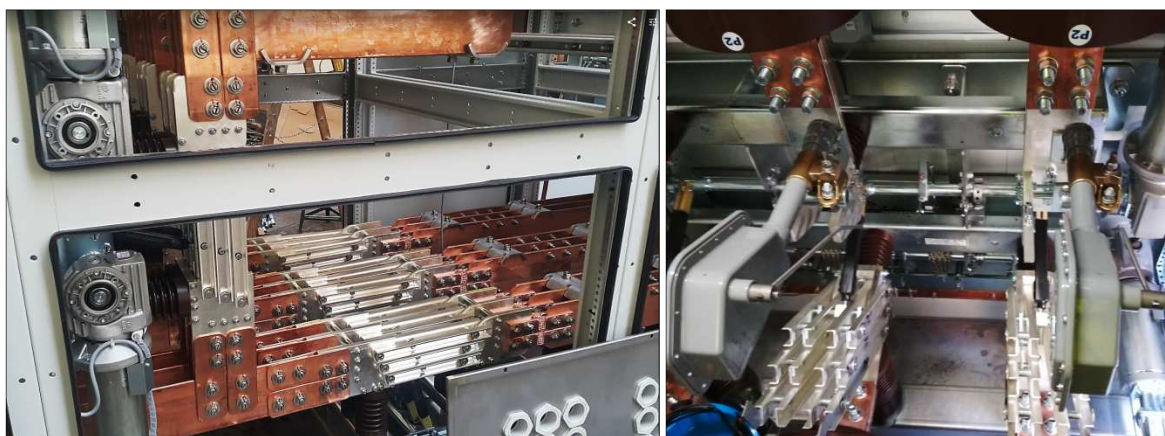
Ukázka instalovaných přístrojů IVEP – odpojovač, uzemňovač, odpínač Example of devices of IVEP origin installed in the switchboard: disconnector, earthing switch, switch disconnector
