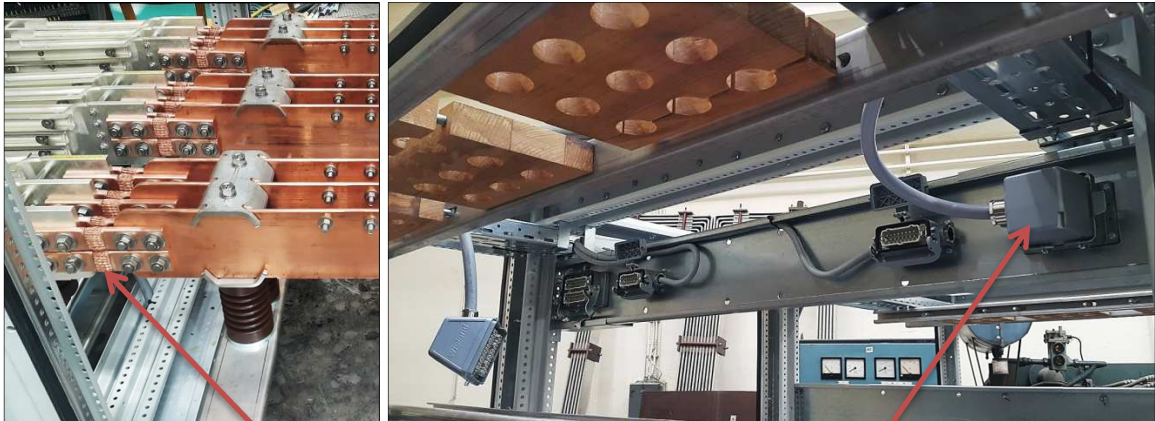
Spoj sekcí - VN propojení, NN propojení Interconnection of the sections among one another – MV and LV interconnections
