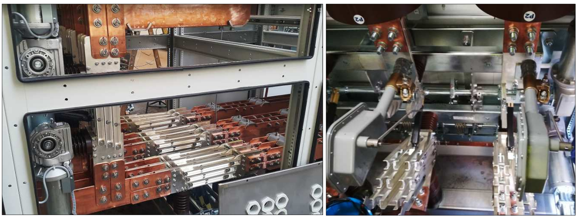
Ukázka instalovaných přístrojů IVEP – odpojovač, uzemňovač, odpínač Example of devices of IVEP origin installed in the switchboard: disconnector, earthing switch, switch disconnector
